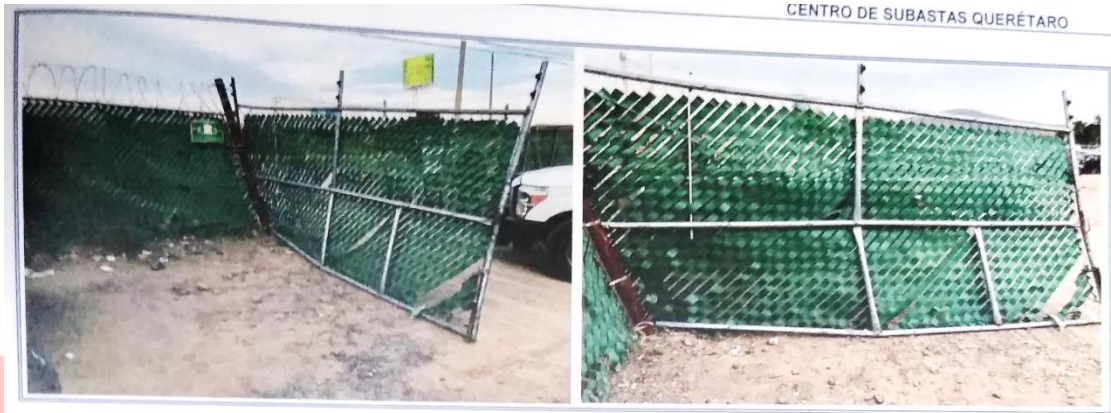
Daño de grúa a puertas de acceso de malla ciclón
